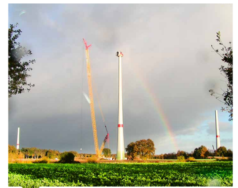
Mit Hochdruck wird am Windpark Spahnharrenstätte gearbeitet – Ende 2016 sollen alle Windenergieanlagen am Netz sein
